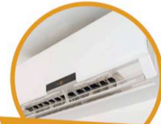
Air Conditioner di setiap lantai
